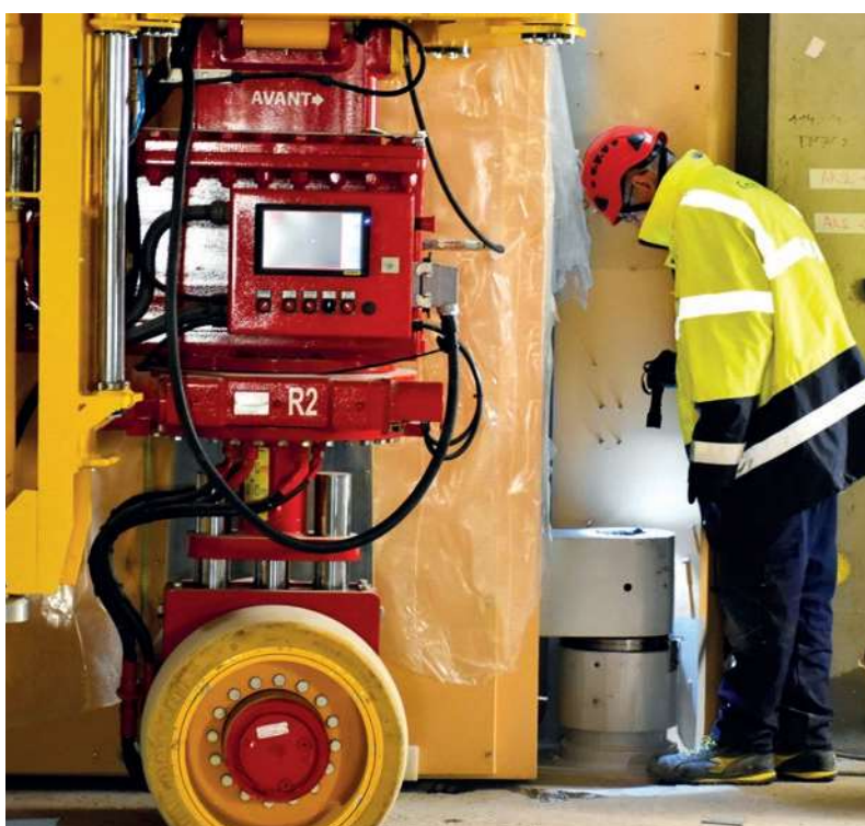
Une porte nucléaire de 60 tonnes est installée à la sortie d'une galerie menant au tokamak. C'est une opération qui se répétera 46 fois tout autour de la machine. Ici, un technicien vérifie l'installation de la porte sur ses chaudières. Novembre 2018.
