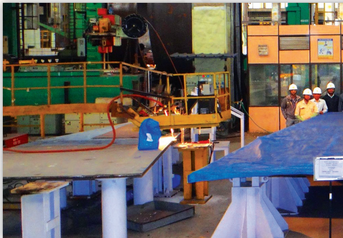
Novembre 2014. Les plaques d'Industeel pour la construction du Cryostat sur le site de Larsen & Toubro à Hazira, Inde. © ITER Organization
